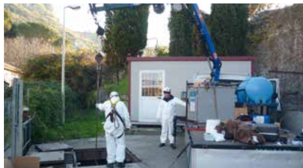
Manutenzione delle pompe ITT-FLYGT poste in un locale quota fiume
